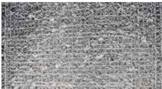
4. ábra: Eredeti (maratlan), hosszában és hosszában-keresztben bemart aszfalt felület
