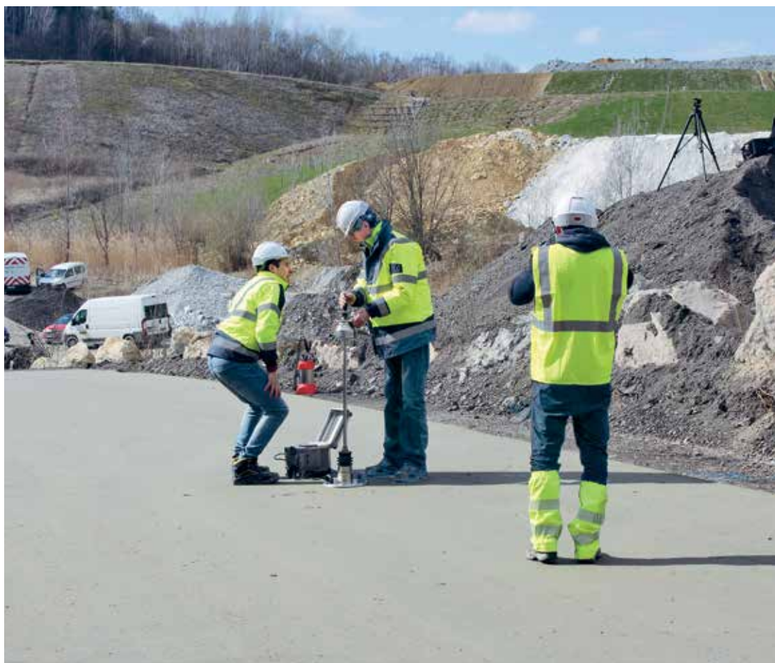
A beépítést folyamatos frissbeton vizsgálatokkal, továbbá a tömörítettség ellenőrzésével végezték egyrészt roncsolásmentes testsűrűség méréssel, Troxler-szondával, valamint ejtősúlyos, könnyű behajlás mérővel
