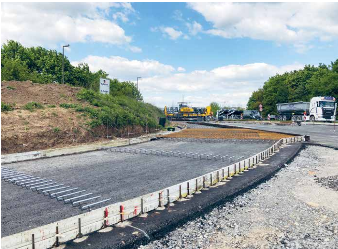
Egy hálósalt, geometriailag kényes szakasz betonozás előtt. A későbbi vakhézagok alatt kosarakra támasztott teherátadó vasak („dűbelek”).
