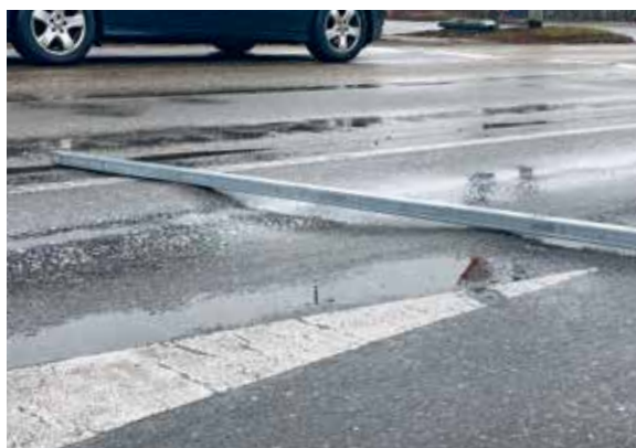
Benyomódások az aszfaltban a túl nagy terhekből fékezés, állva járatás és indítás miatt
