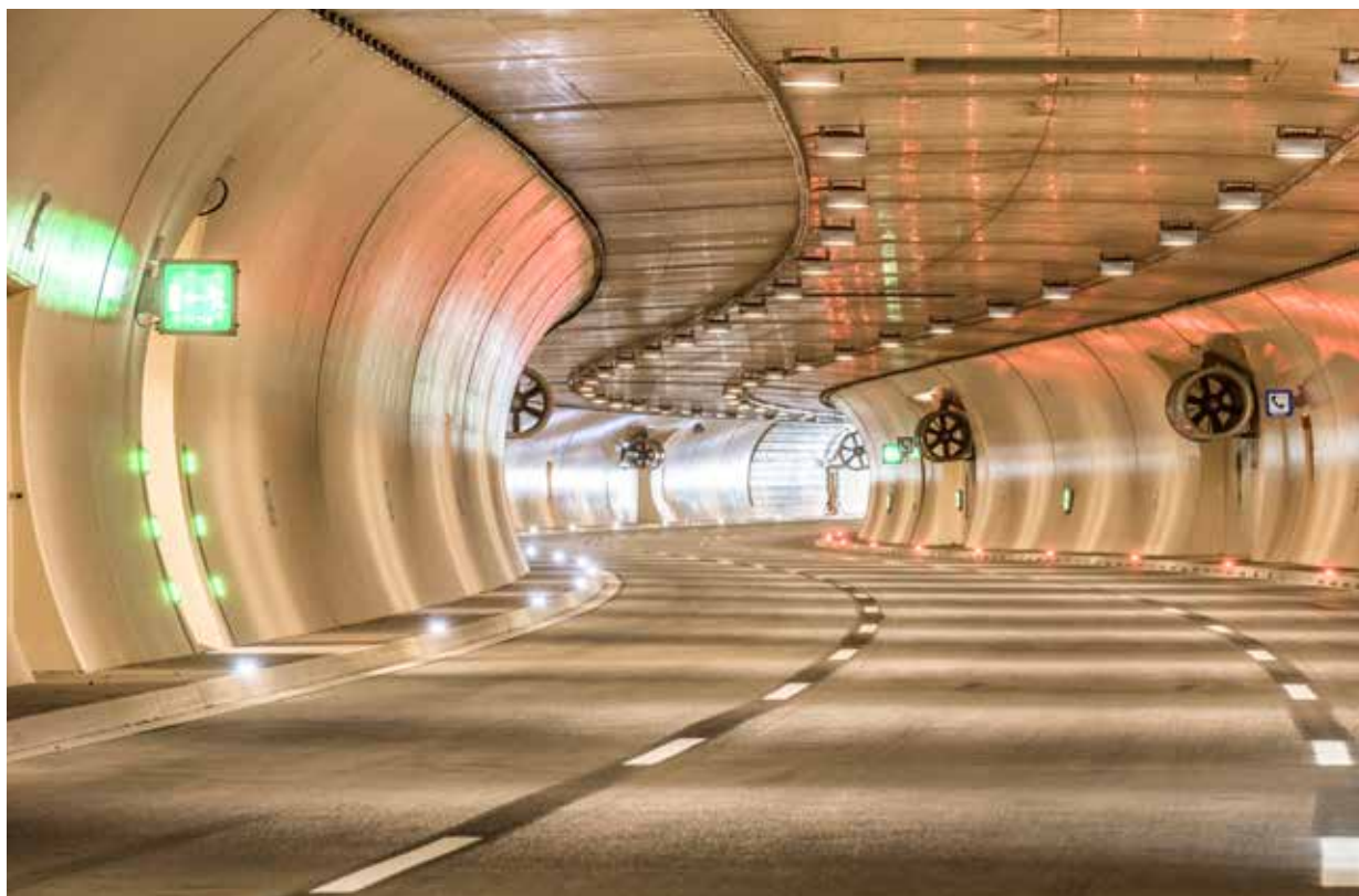
Az alagutak betonburkolatos építésének két előnye van: a beton kedvező fénytechnikai viselkedése miatt, a szubjektív biztonságérzet növekszik és a világosítási energiaigény csökken. (A képen: a Götschka alagút, Felső-Ausztria)
