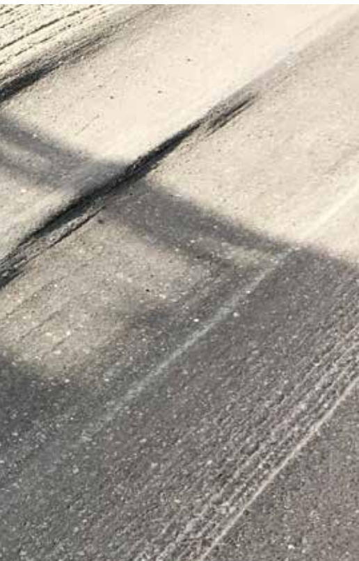
A nagy burkolathőmérséklet és a nehézjármű forgalom okozta nyomvályúk aszfaltburkolaton.
